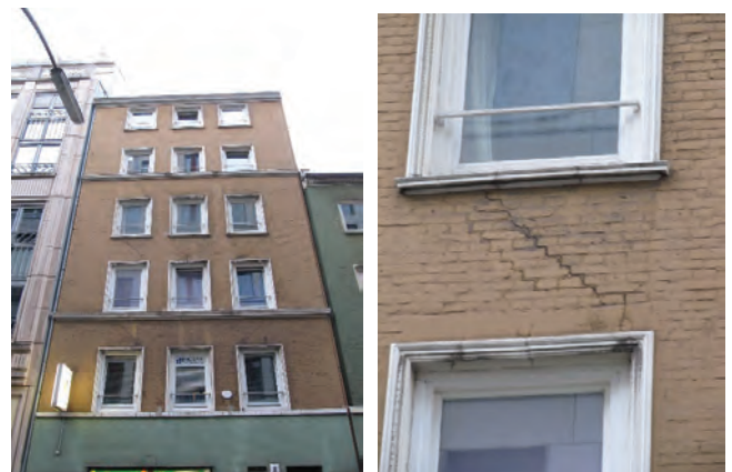
Gebäude mit Schäden?
