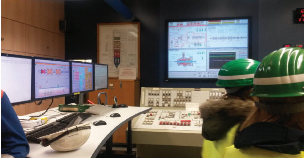
Blick in den Leitstand des Kraftwerks
